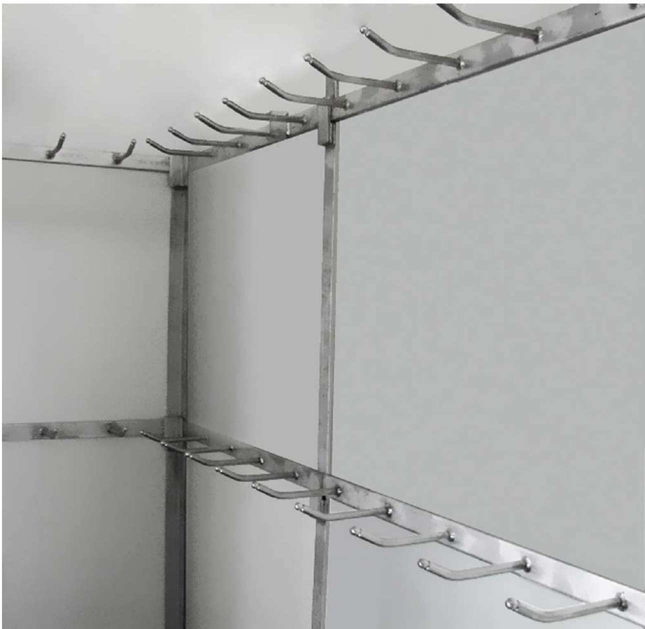
Ανοξείδωτα τσιγκέλια στο εσωτερικό ψυκτικού θαλάμου κρεάτων | Inox hooks inside a cold room for meats
